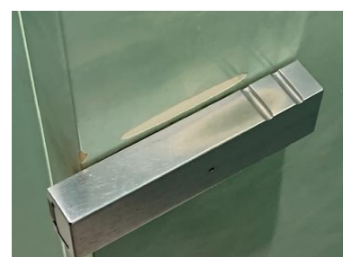
トイレ個室扉レバー
