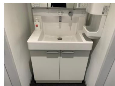
控室洗面台(3箇所)
